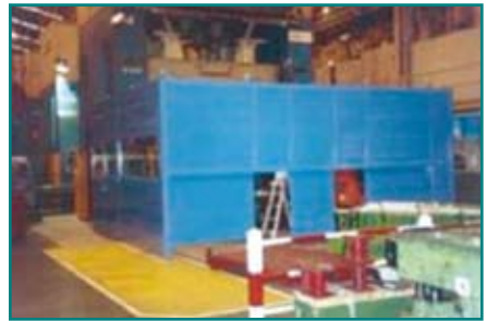
Perimetral acústico con puertas de elevación
